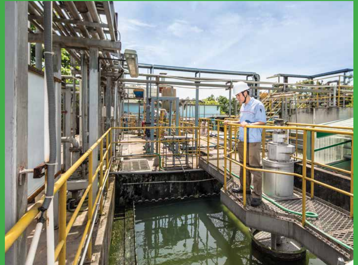
Hệ thống xử lý nước thải tại nhà máy TMV Wastewater treatment system at TMV's plant
